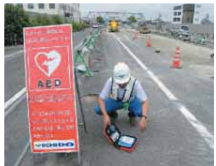
現場にAED装置(岡山)
