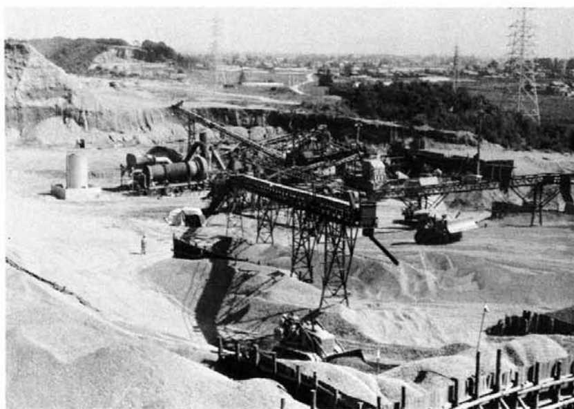
東名高速工事用砕石プラント 全景
