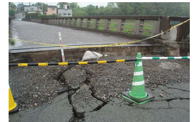
地震により取付部の舗装が約80cm沈下した八竜橋
