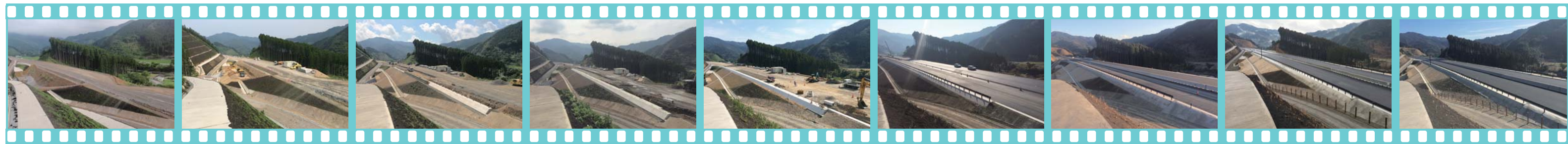
東九州道(佐伯～蒲江)青山地区舗装工事 着工から完成までの定点写真
