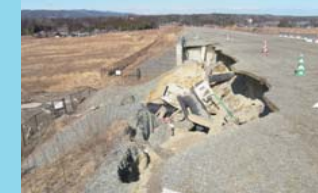
雨水の集中により路肩部・盛土法面部の崩落が拡大
