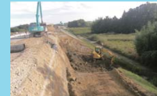
盛土法面部復旧(はらみ箇所)
