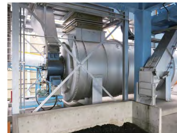
燃焼式脱臭装置
