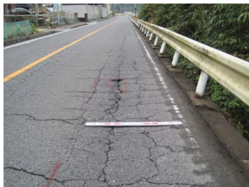
施工前の路面状況
