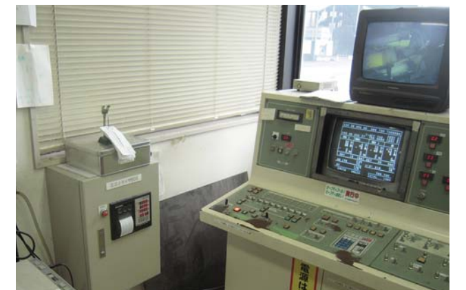
合材プラントのデマンドコントローラー(左)
