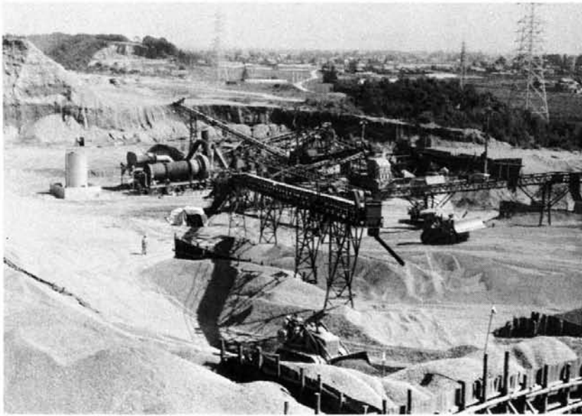
東名高速工事用砕石プラント 全景
