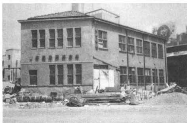
地下鉄工事でいたみ出した旧本社社屋
