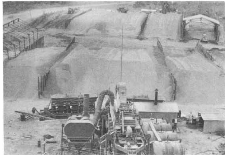
名神高速工事用のアスファルトプラントとストックヤード
